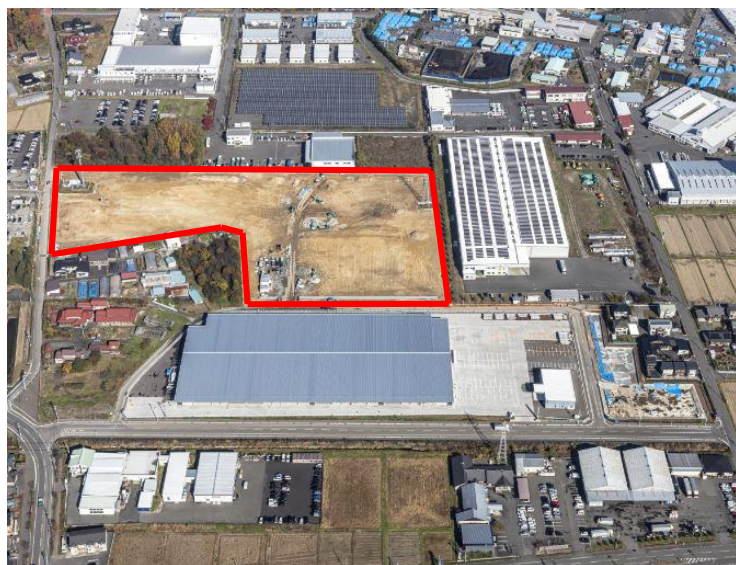
(2)民間補助金を活用し、市内で新たに建設している大和ハウス工業(株)様のD P L岩手花巻Ⅱの建設工事の様子
